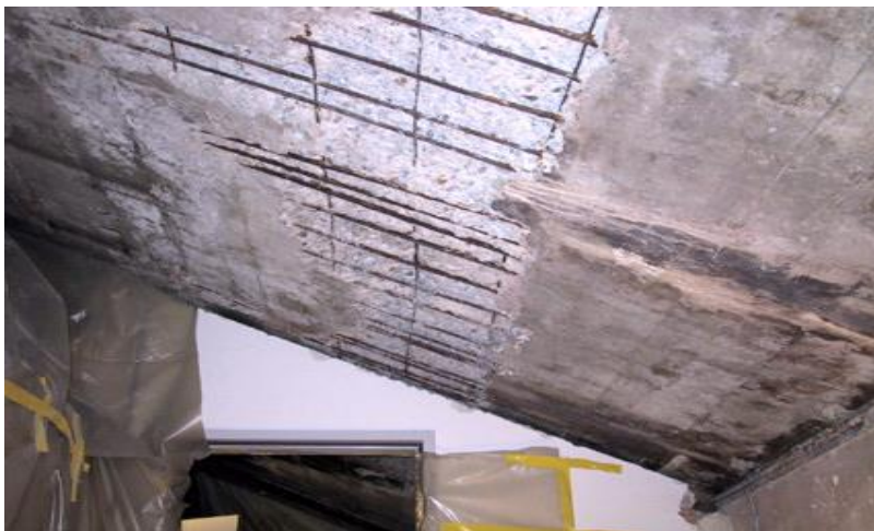
Soletta esposta all'acqua per lunghi anni: calcestruzzo deteriorato e indebolito, acciaio d'armatura corroso con perdita di capacità portante
