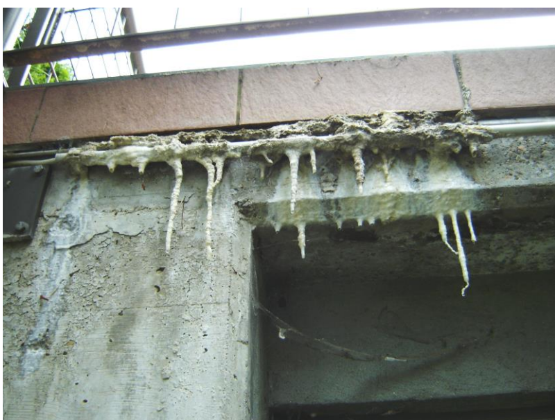
Come in una grotta, le stalattiti di calcare provengono dal discioglimento dei sali; in questo caso quelli del massetto nel pavimento della terrazza, non protetto da una efficace impermeabilizzazione. Il processo di disgregazione è in corso.
